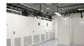
無停電電源装置(UPS)
