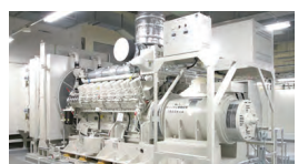
非常用発電機
