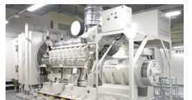
非常用発電機
