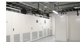
無停電電源装置 (UPS)
