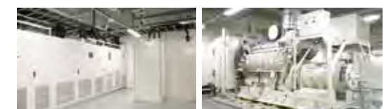
無停電源装置(UPS)
